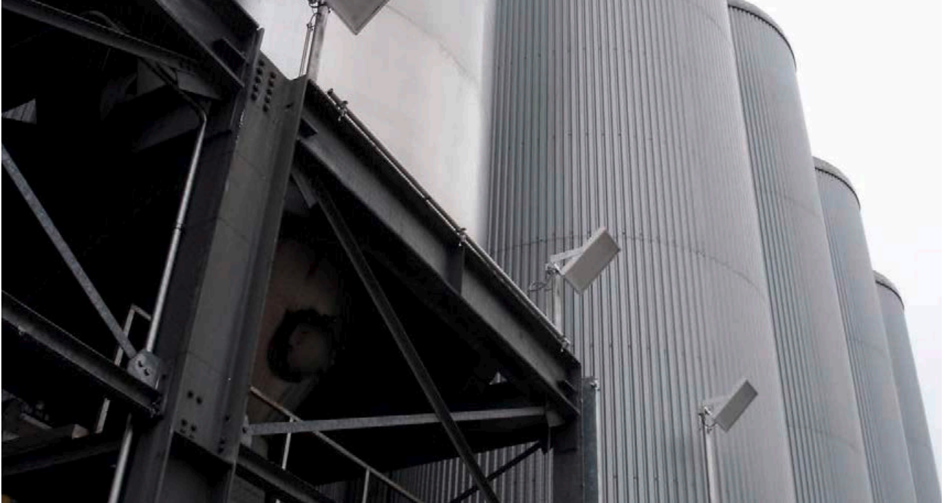
Außenstrahler SHL 062 an Silofassade bei Tag ...
